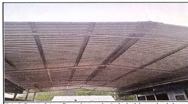
Foto 6: En esta fotografía se observa el entechado del corredor de la escuela.
