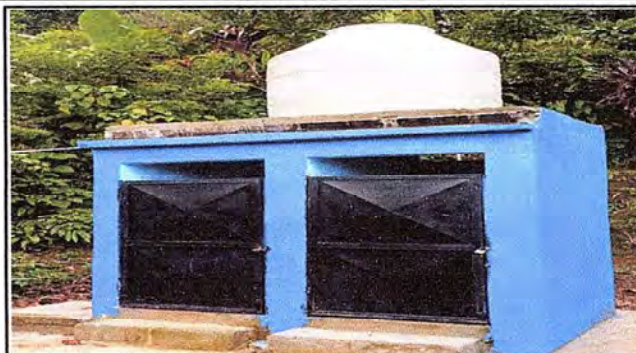
Foto 2: En esta fotografía se puede apreciar el mejoramiento de los baños y la intrusión del agua, en la terraza de los baños se colocó el tinaco para que falte el agua en la escuela.
